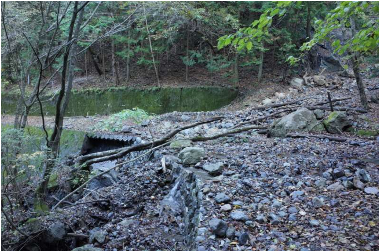
土砂崩れがあったり
